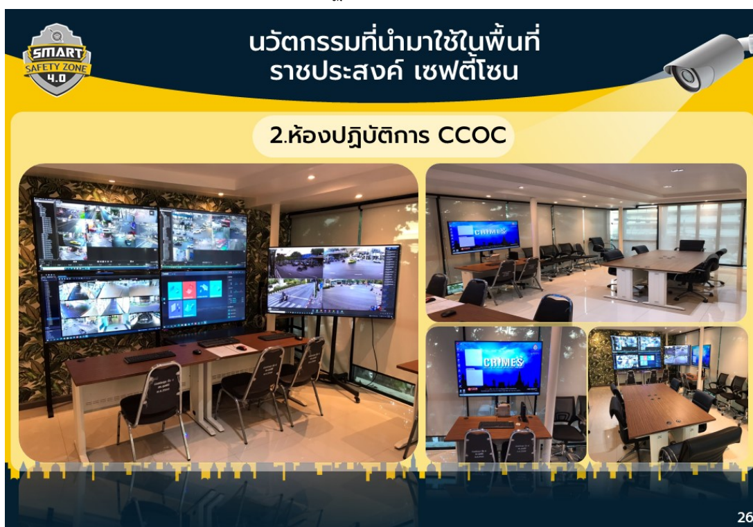
ภาพห้องปฏิบัติการควบคุมสั่งการ ในระยะแรก ที่ใช้ในโครงการ Smart Safety Zone 4.0 ที่มา : ข้อมูลการนำเสนอของสถานีตำรวจนครบาลลุมพินี , 2564
